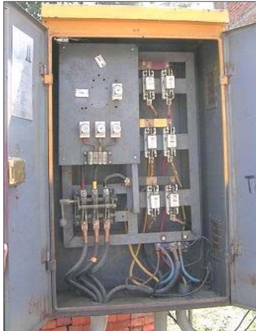
Kondisi (Isi) Panel
