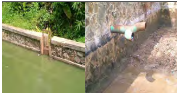
Gambar 85. Pipa Pemasukan dan Pengeluaran Air
