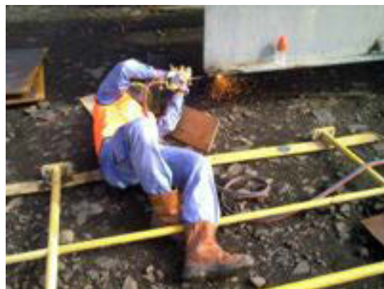
Gambar posisi kerja yang berbahaya
