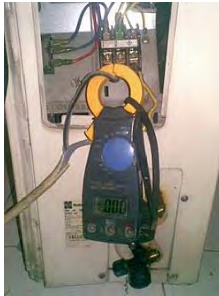
Gambar 4. 25 Pengukuran Arus Motor Kompresor
