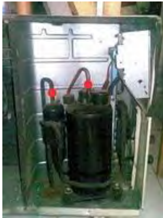
Gambar 4. 24 Kompresor AC Split
