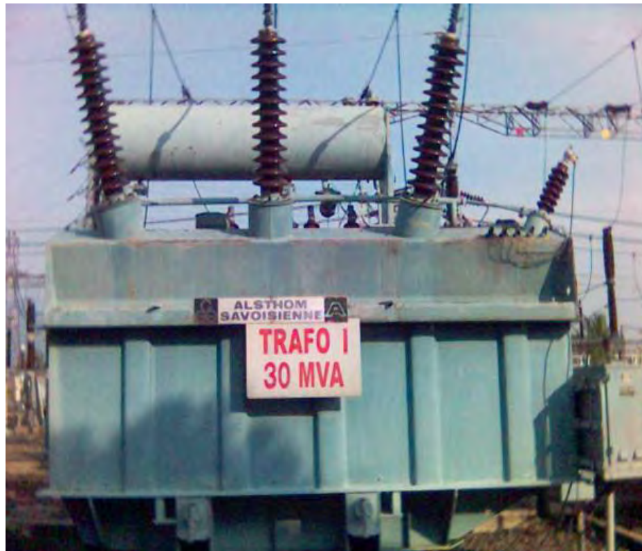
Gambar 3-1. Transformator daya GI Konvensional.
