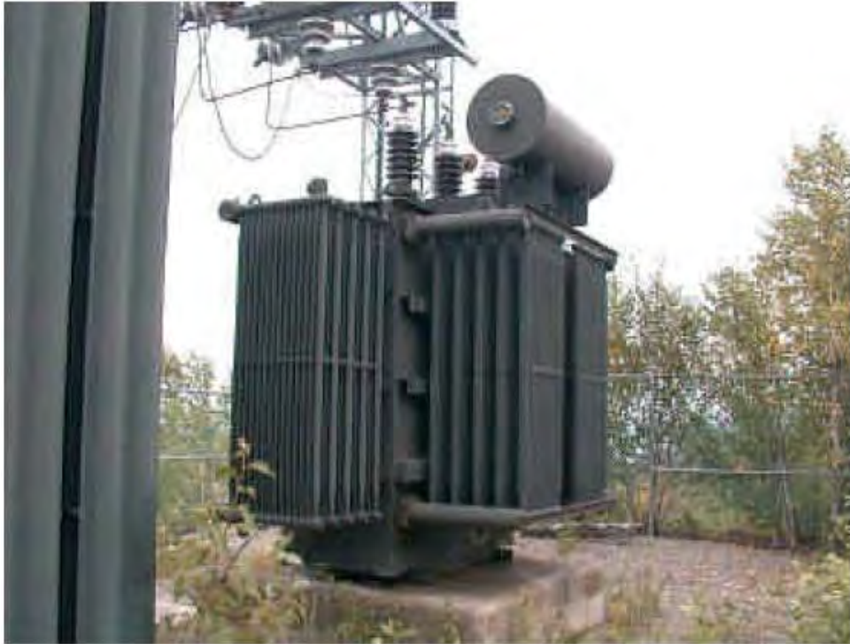
Gambar 3-8. Trafo Pemakaian Sendiri (TPS).
