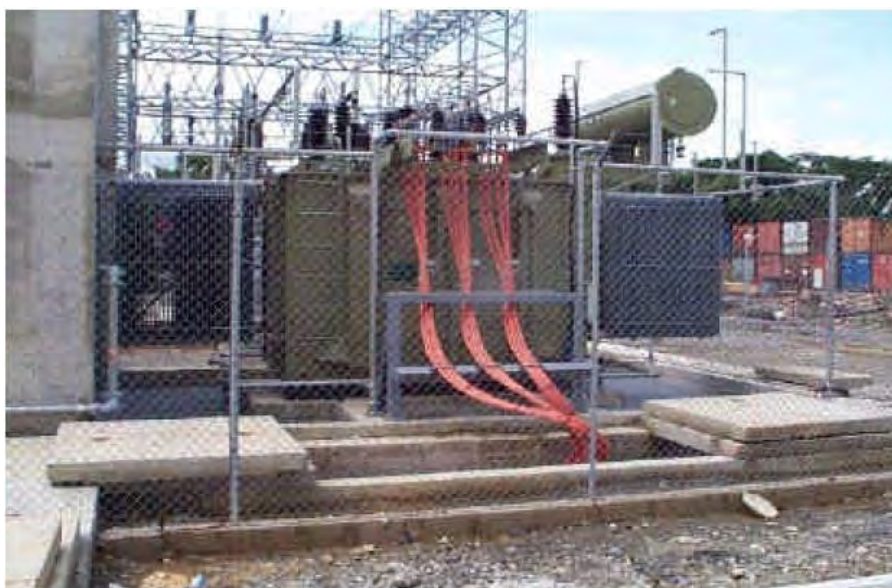
Gambar 4-9. Transformator Distribusi Tiga Phasa.
