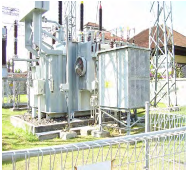
Gambar 7-1. NGR yang terpasang di Gardu Induk.
