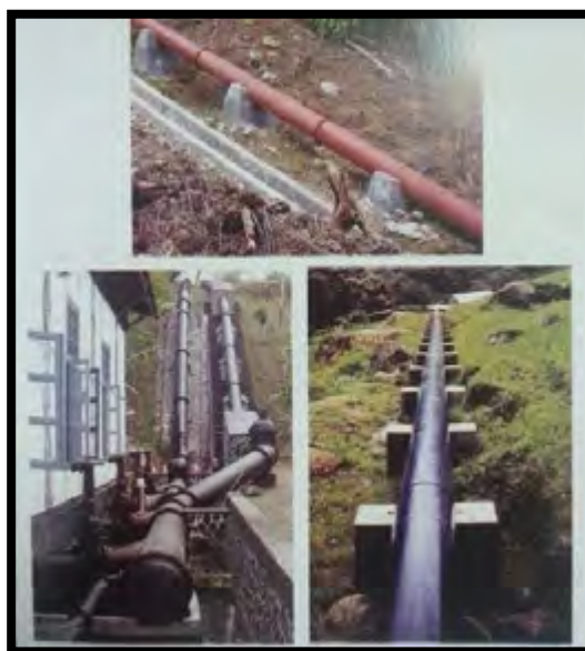
Gambar 9. Pipa Pesat atau Penstock
