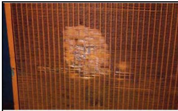
Gambar 10.90 Fin radiator mengalami kerusakan
