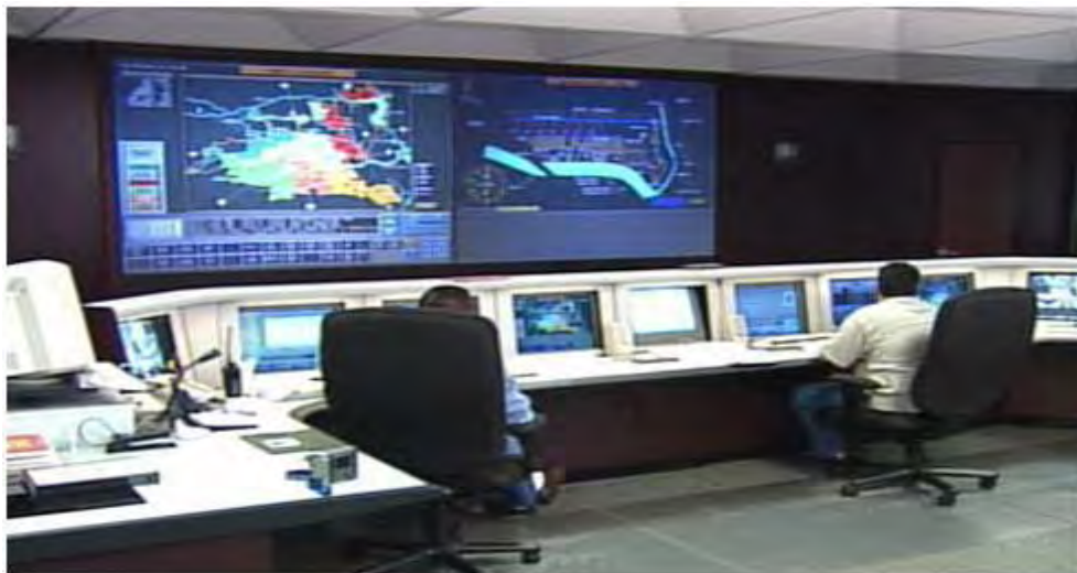
Gambar 4.4 Sebuah Master Control Room untuk mengontrol Sistem Proses Jarak Jauh
