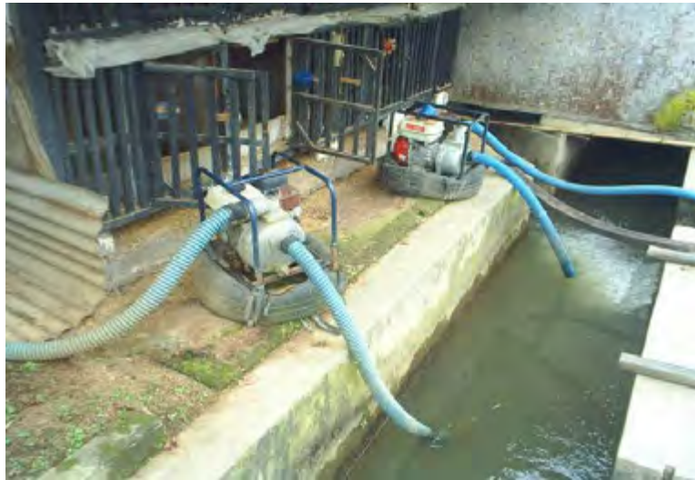
Gambar 15. Pompa penyuplai air pada kolam air deras
