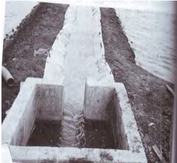
Gambar 15. Saluran pemasok air di atas tanggul dengan saluran tanah yang dilapisi plastik
